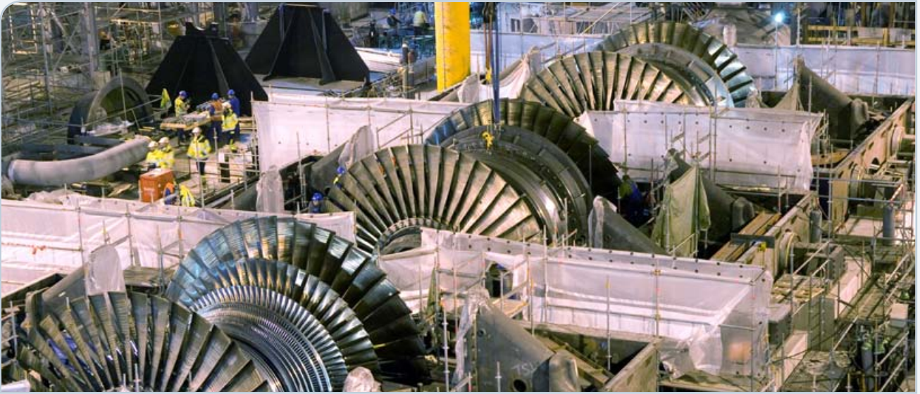
OL3-turpiinlaitoksella turpiinit, generaattori ja magnetointikone on asennettu paikoilleen.
