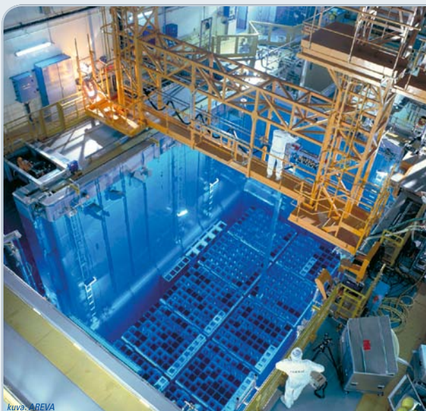
Polttoainerakennuksessa varastoidaan sekä tuoretta että reaktorista poistettua polttoainetta. Vuoden aikana käytetyn polttoaineen radioaktiivisuus vähenee sadasosaan.
