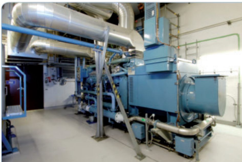
Neljä dieselgeneraattoria huolehtii laitoksen varavoiman syötöstä.
