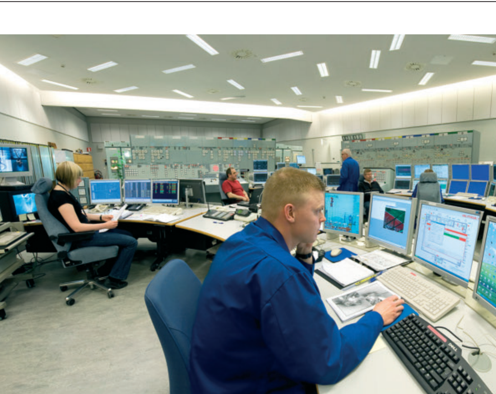
Vuosihuoltoa tarkkaillaan valvomosta.
