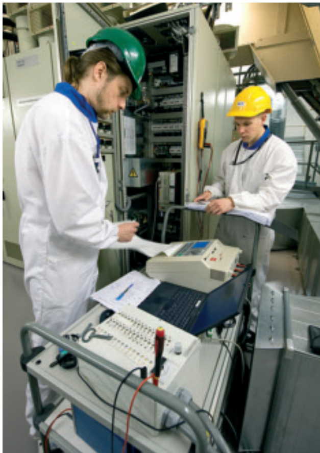
Reaktorin pääkiertopumpun taajuusmuuntajan toimintakoe.
