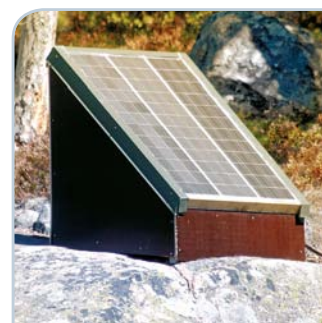
Tuuli, peltobiomassa ja aurinkopaneelit soveltuvat pienimuotoiseen sähköntuotantoon.
