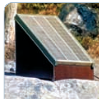
Tuuli, peltobiomassa ja aurinkopaneelit soveltuvat pienimuotoiseen sähköntuotantoon.
