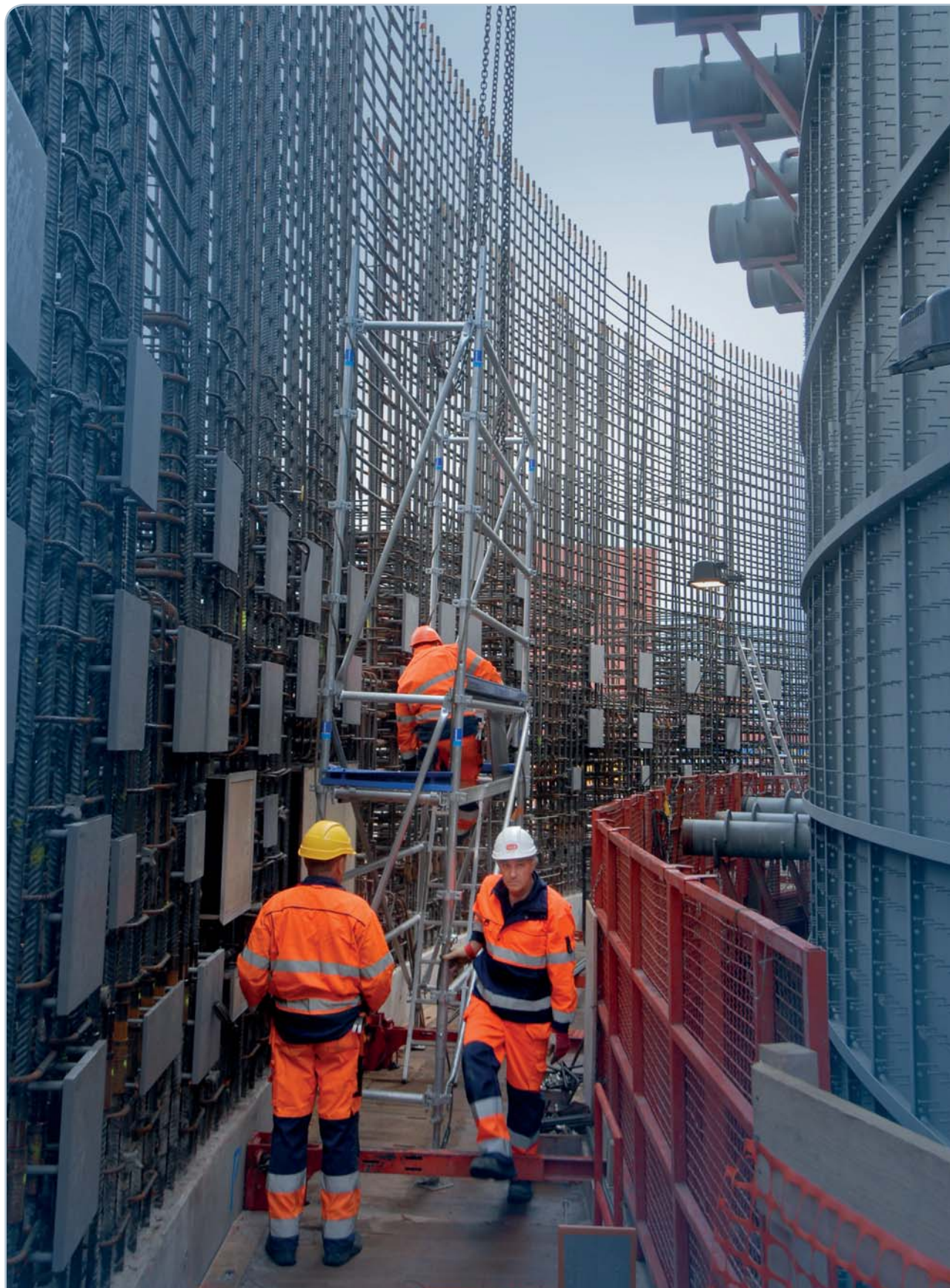
Bild 20 Reaktorinneslutningen omges av ett krockskydd av armerad betong (på bilden till vänster). Bild: TVO.
